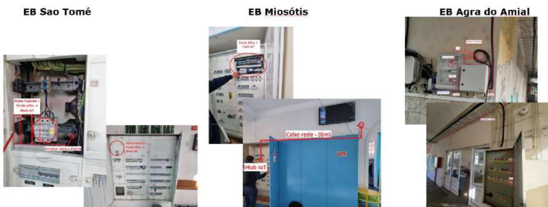
Figura 27 – Imagens dos equipamentos instalados nas escolas
