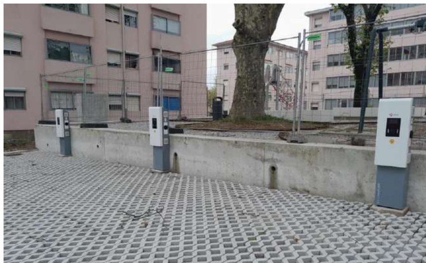
Figura 14 – CVE instalados no bairro de Agra do Amial
