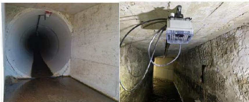
Figura 4 – Registo fotográfico de alguns sensores instalados
