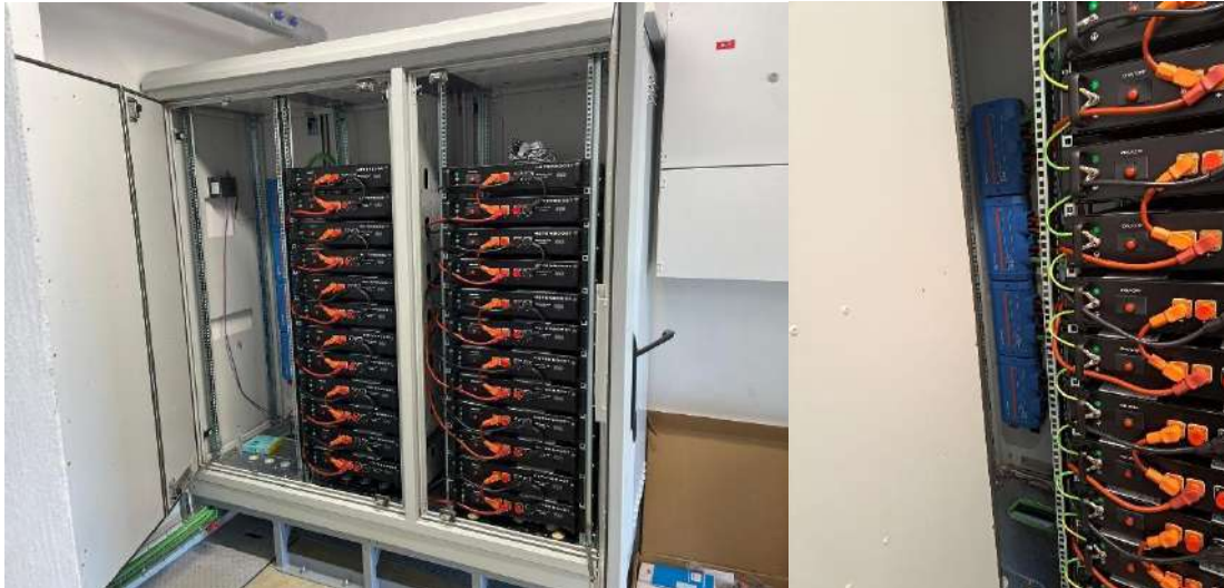
Figura 4.10 – Imagem da bateria instalada
